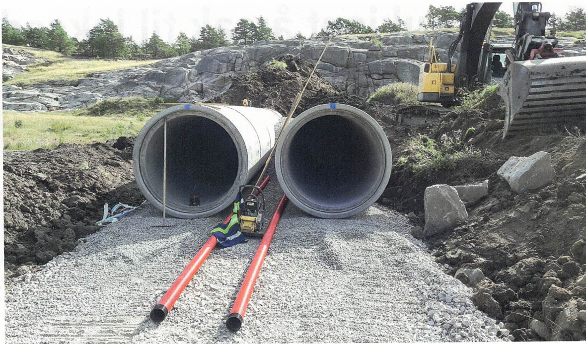
På den nye riflebanen til Fredrikstad-foreningen skytes det gjennom to 100 meter lange rør, laget av betongelementer, som er gravd ned. Standplass er ei lydisolert brakke.
